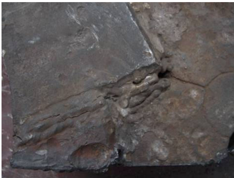
Figura 4: Detalle de la fisura desde el casete hasta el tarugo
