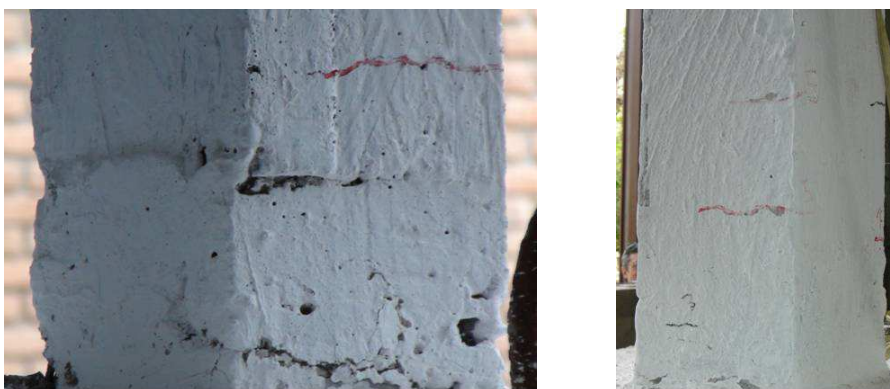
Figura 7-a: Fisuras en columnas del pórtico sin refuerzo, luego de aplicar los 6 inputs dinámicos.
