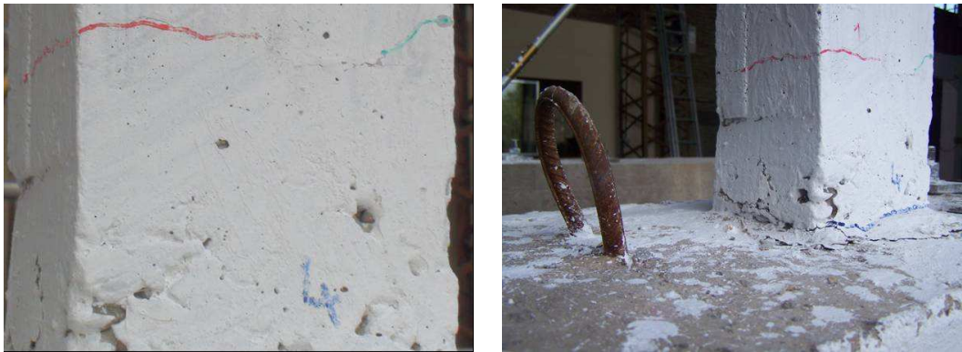
Figura 7-b: Fisuras en columnas del pórtico sin refuerzo, luego de aplicar los 6 inputs dinámicos.
