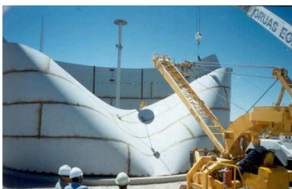
Figura 23: Deformación tanque real luego de extraer parte de la quinta virola.
