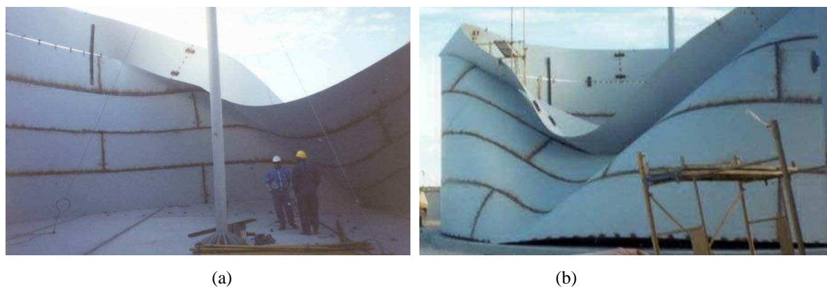
Figura 3: Tanque colapsado, (a) Vista interior, (b) Vista exterior.
