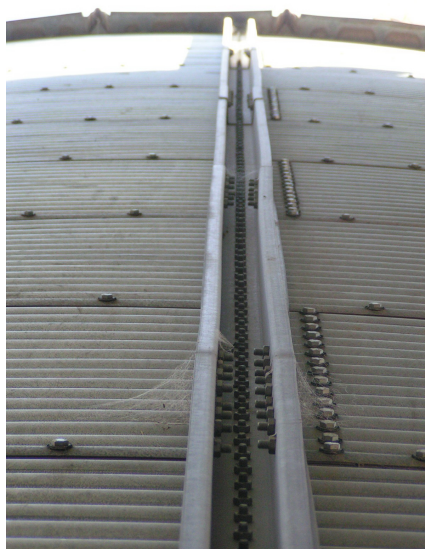
Figura 4: Vista general de la deformación de las alas de los perfiles, provocada por pandeo local flexo-torsional.
