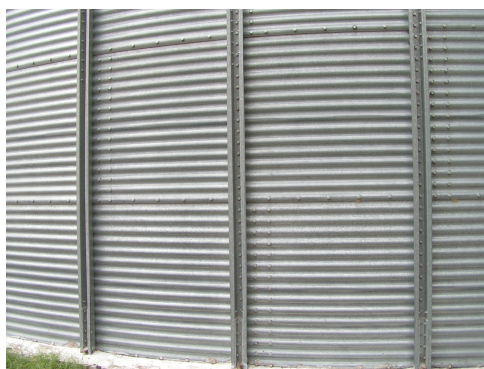
Figura 1: Vista parcial de parantes de refuerzo abulonados en el alma del perfil a las chapas de cerramiento.
