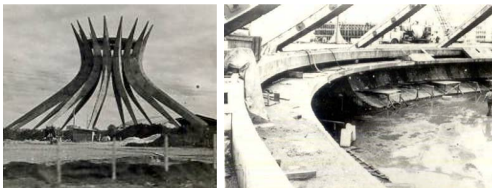
Figura 11: Estrutura dos pilares e detalhe da construção do anel de tração na base da Catedral de Brasília, 1959 Fonte: Arquivo Público do DF
